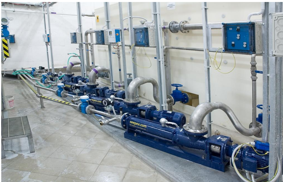
Obr. 5 Vřetenová čerpadla kalu SEEPEX dopravující vápenné mléko z homogenizační nádrže do sytičů.
