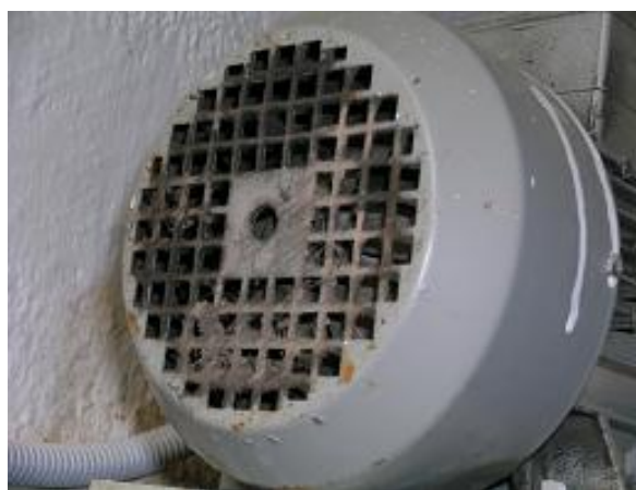
Obr. 4 Ventilátor odradonovací věže
