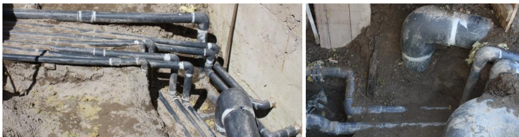
Obr. 6 Pohled na provedenou pokládku potrubí a absenci opěrných bloků.
