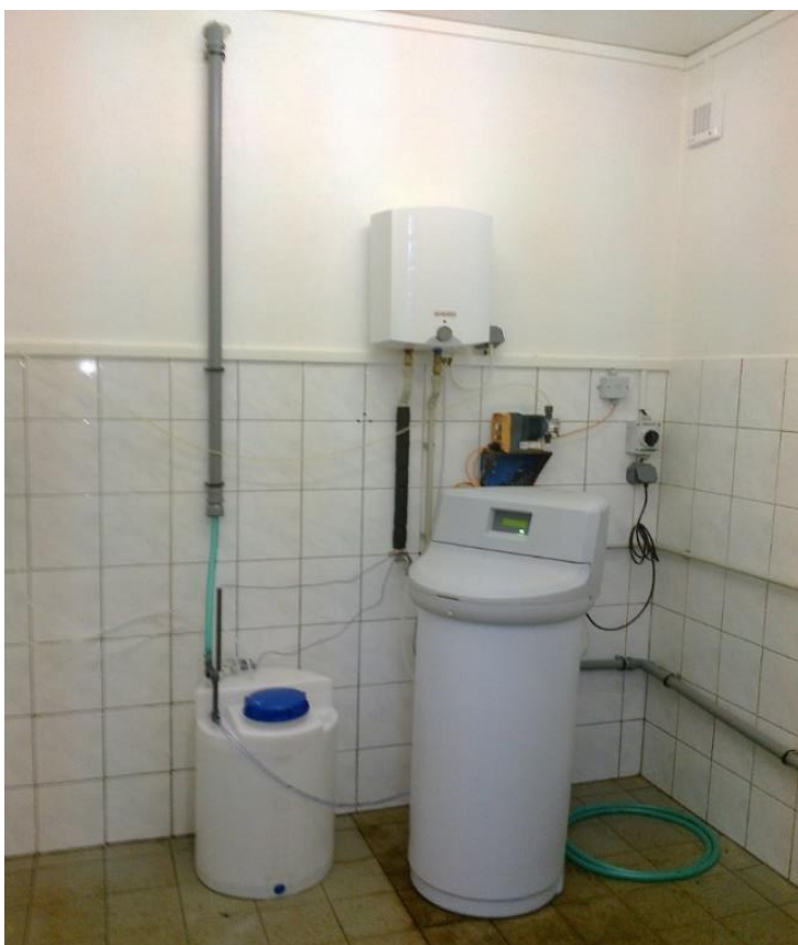
Obr. 5 b. Aplikace zařízení na výrobu směsných oxidantů pro oxidaci železa, manganu a dokonce i arsenu – pohled na generátor směsných oxidantů
