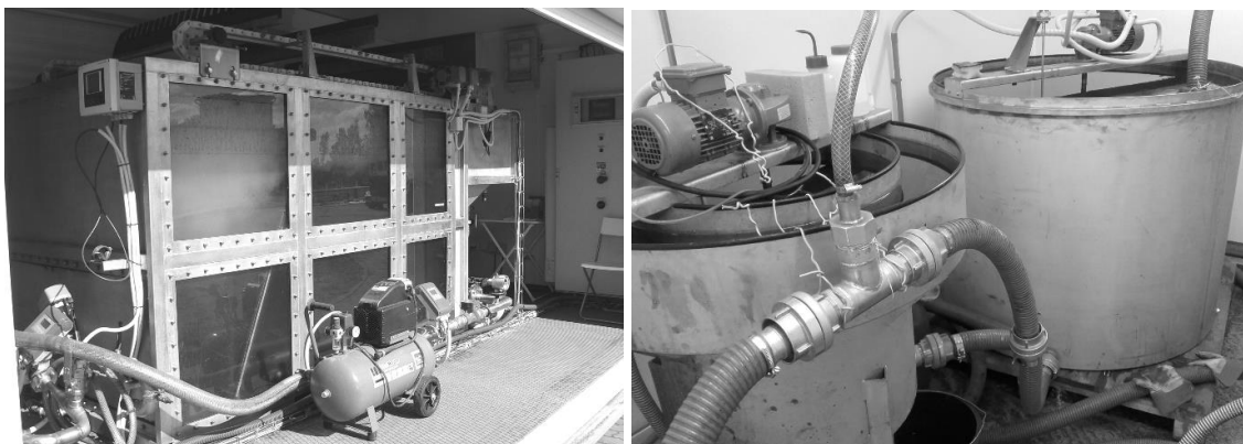
Obr. 2 Vnitřní vybavení kontejnerů – flotační nádrž (vlevo), nádrže rychlého a pomalého míchání (vpravo)
