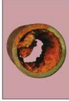
VODOVODNÍ POTRUBÍ S NECHRÁNĚNÝM VNITŘNÍM PLOCHEM
