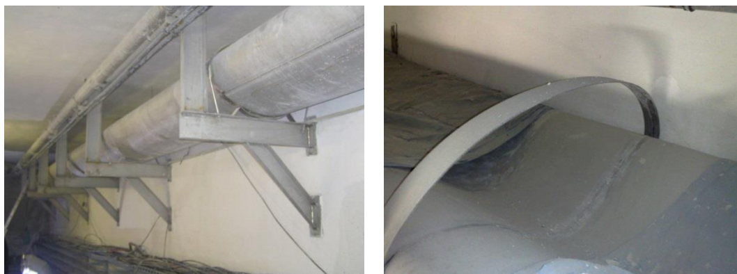
Obrázek 2: Ztráta stability tvaru – nerez potrubí – důsledek podtlaku při hydraulickém rázu
