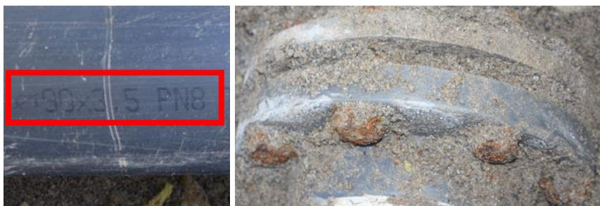
Obr. 5 Nedodržení požadovaného tlakového potrubí a koroze šroubů na přírubě
