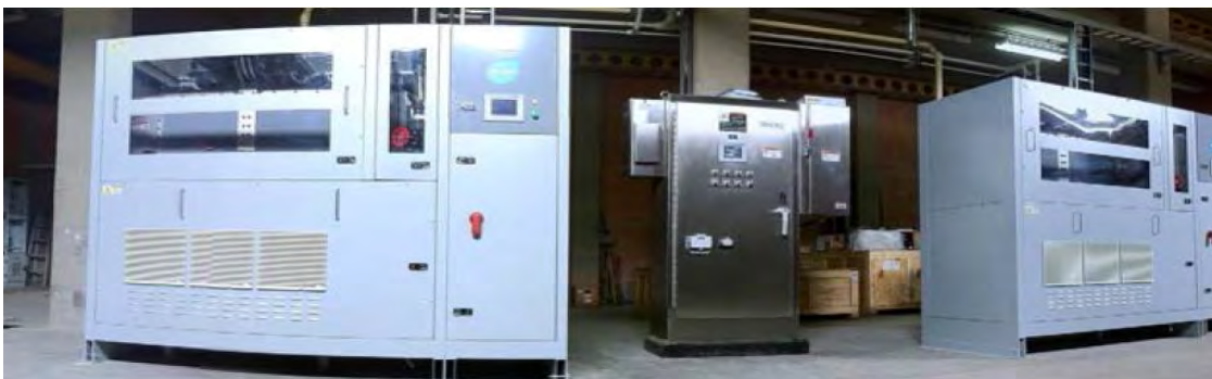
Obr. 2 Aplikace směsných oxidantů pro dezinfekci a hygienické zabezpečení pitné vody přináší provozovateli mj. lépe říditelný zbytkový oxidant, takže jsou zajištěny dobře i nejvzdálenější části sítě, často i bez nutnosti dochlorování.
