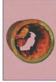
VODOVODNÍ POTRUBÍ S NECHRÁNĚNÝM VNITŘNÍM PОВRCHEM
