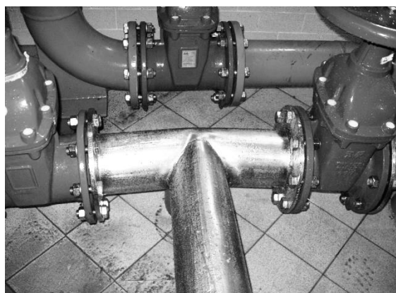
Obrázek 3: Nadměrná deformace – důsledek poddajnosti tenkostěnné trubky při běžném přetlaku
