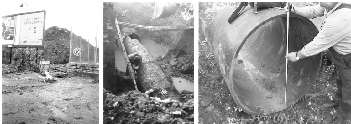
Obrázek 1: Porušení potrubí – důsledek přetížení nadnásypem – litina stáří 90 let bez známek koroze
