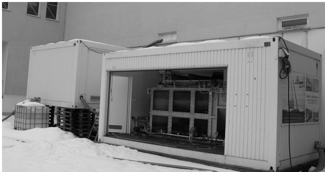
Obr. č. 3: Umístění technologických kontejnerů před provozní budovou ÚV Karolinka
