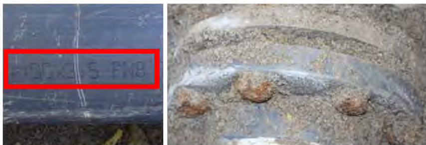
Obr. 5 Nedodržení požadovaného tlakového potrubí a koroze šroubů na přírubě
