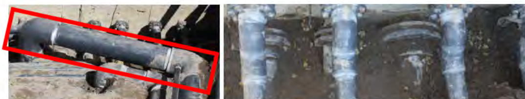
Obr. 7 Pohled na potrubí D315, u kterého došlo k největšímu svislému posunu a pohled na nevhodně provedenou opravu prasklého potrubí, kdy nelze jednoduše potrubí odvodnit.
