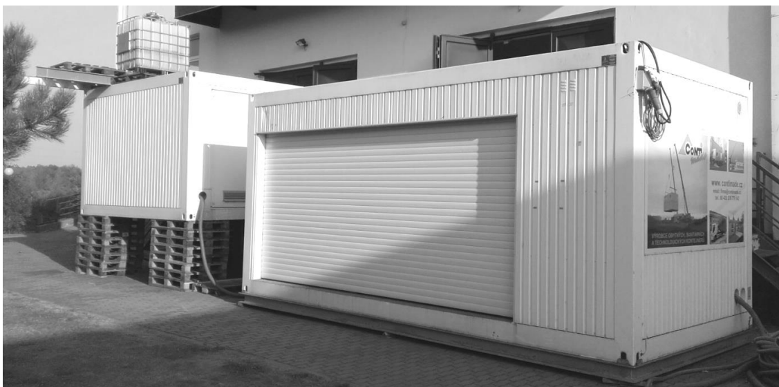
Obr. 1 Kontejnery flotace a koagulace v prostoru před strojovnou ÚV Hrobice
