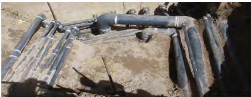
Obr. 4 Pohled na odkryté potrubí v místě u hlavní strojovny.
