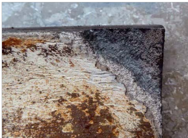
Obrázek 2 Odřezek litinové trouby s částečně odstraněnou výstelkou z cementové malty
