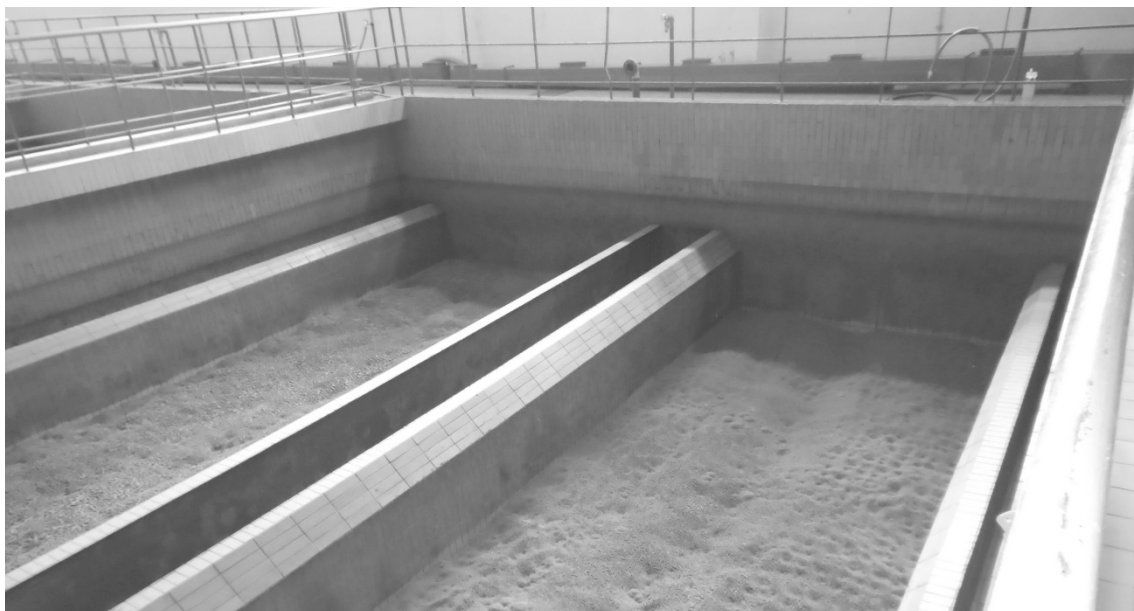
Obr. 1 Původní stav filtrů F7 až F12
