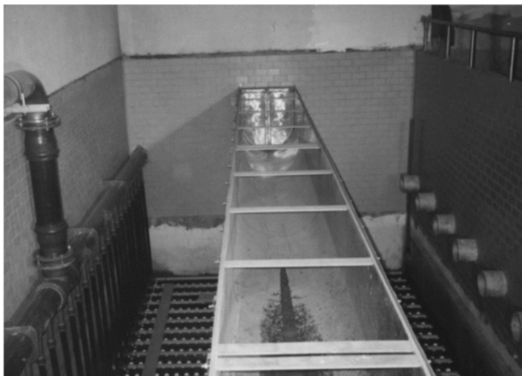
Obr.2 – drenážní systém Aquafilter (ÚV Meziboří)
