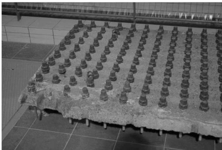
Obr.1 – poškozená betonová mezidna (ÚV Plzeň)
