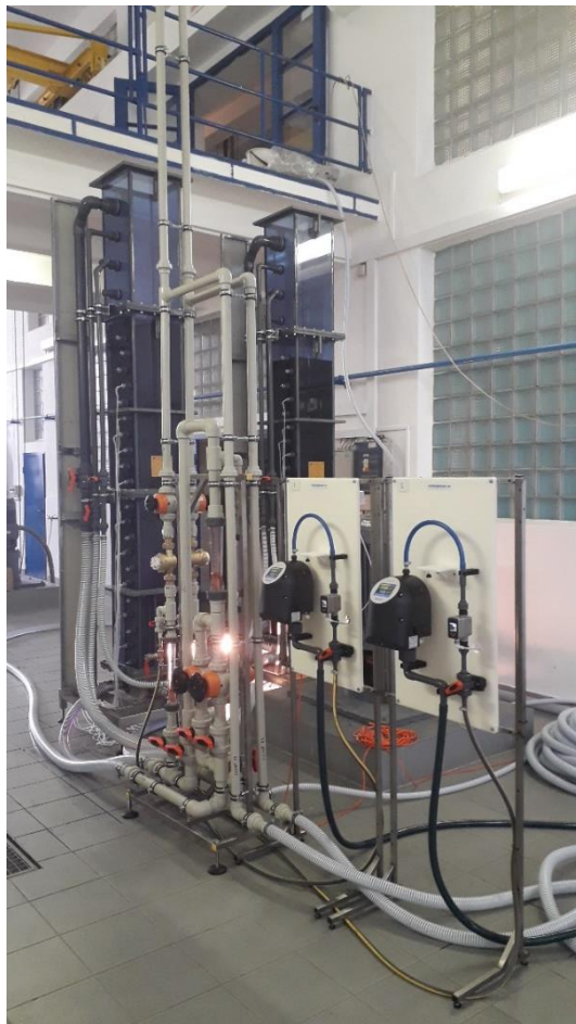
Obr. 1: Poloprovozní filtrační kolony MEMSEP na ÚV Kněžpole
