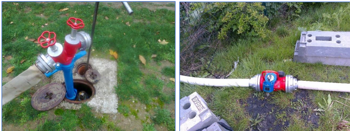
Obr. 6 Požární hydrant připraven pro měření tlaku a průtoku
