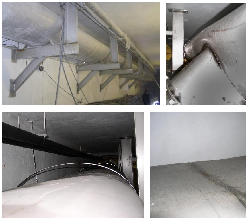
Obr. 4 Poškození potrubí vlivem vzniku podtlaku
