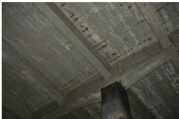
Obr. 1 Původní stav - strop
