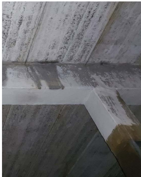
Obr. 1 Strop akumulční nádrže, zatékání vody střešním souvrstvím, nevhodně provedená stěrka
