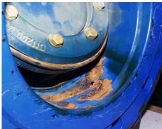
Obr. 8 Poškozené těleso excentrické klapky
