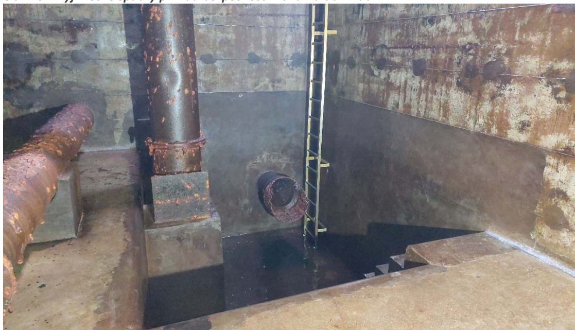
Obr. 10 Výjimečně špatný příklad bezpečnosti v akumulční nádrži
