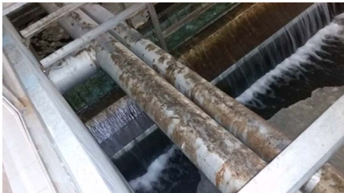
Obr. 2 Koroze způsobená výskytem chloru v ovzduší.
