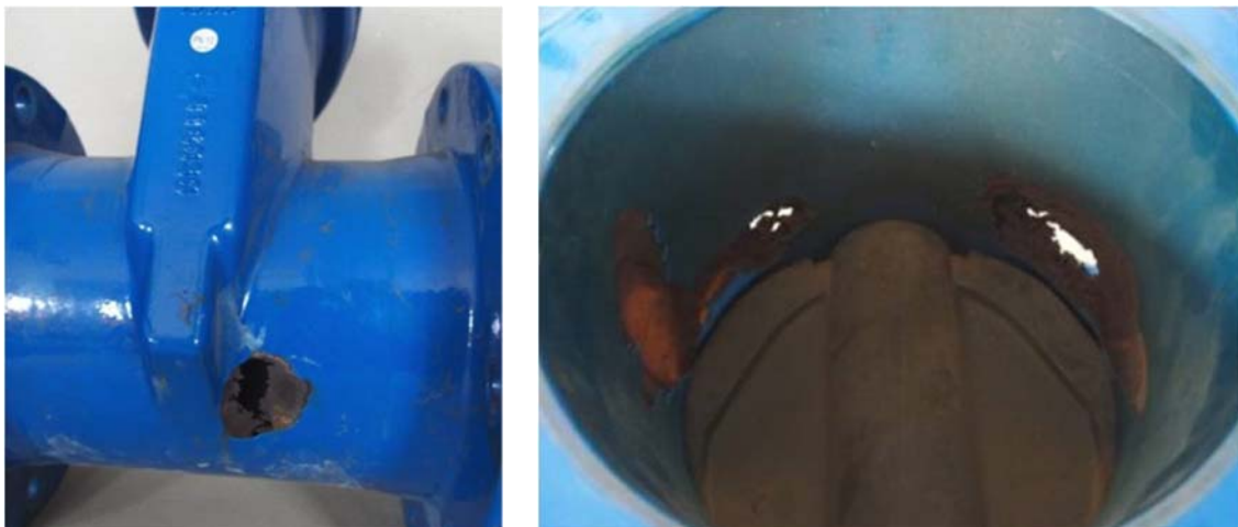
Obr. 4 Destrukce měkkotěsnicího šoupátka po šesti měsících provozu. Zajímavostí je neporušený klín.
