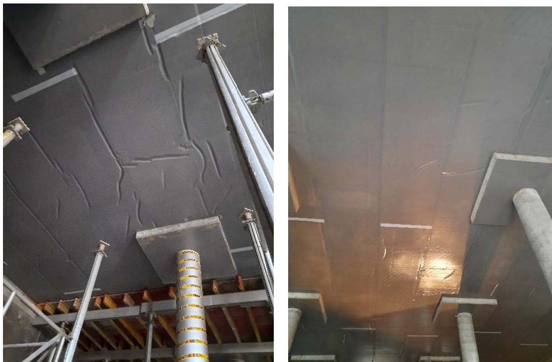
Obr. 3 Použití folie do stropní desky. Vlevo nedodržení technologických podmínek (vznik „vrubů“, Vpravo dodržení technologických podmínek
