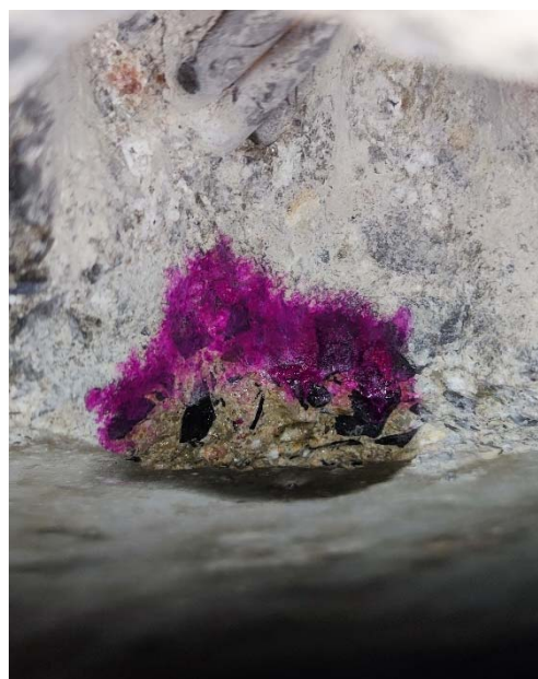
Obr. 4 Stanovení hloubky karbonatce na sekané sondě v dutinovém panelu typu SPIROLL
