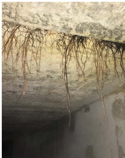
Obr. 2 Strop akumulční nádrže, prorůstání kořenového systému přes střešní souvrství
