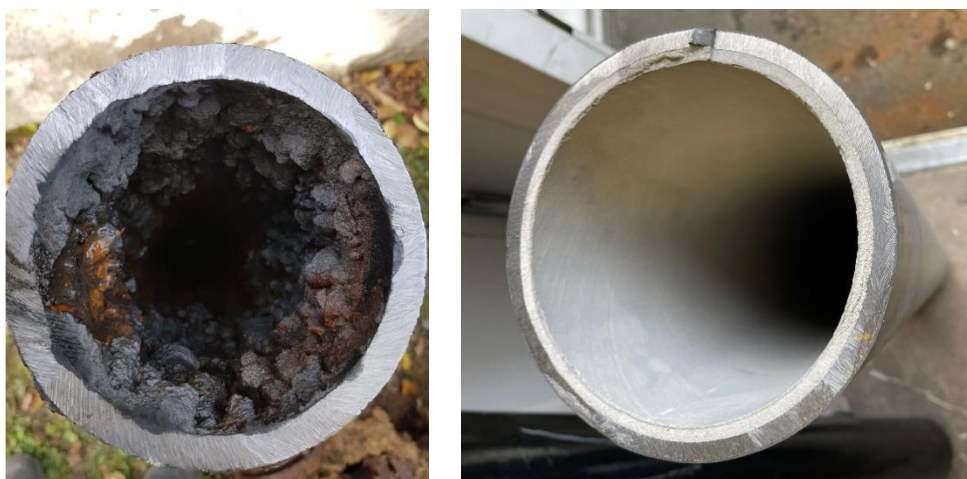
Obrázek 1. Inkrustované litinové potrubí DN 100 výřez v porovnání s novým TLT potrubím
