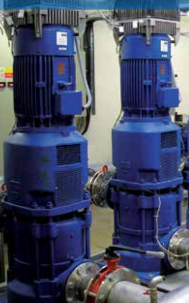
Čerpadla a čerpací stanice
