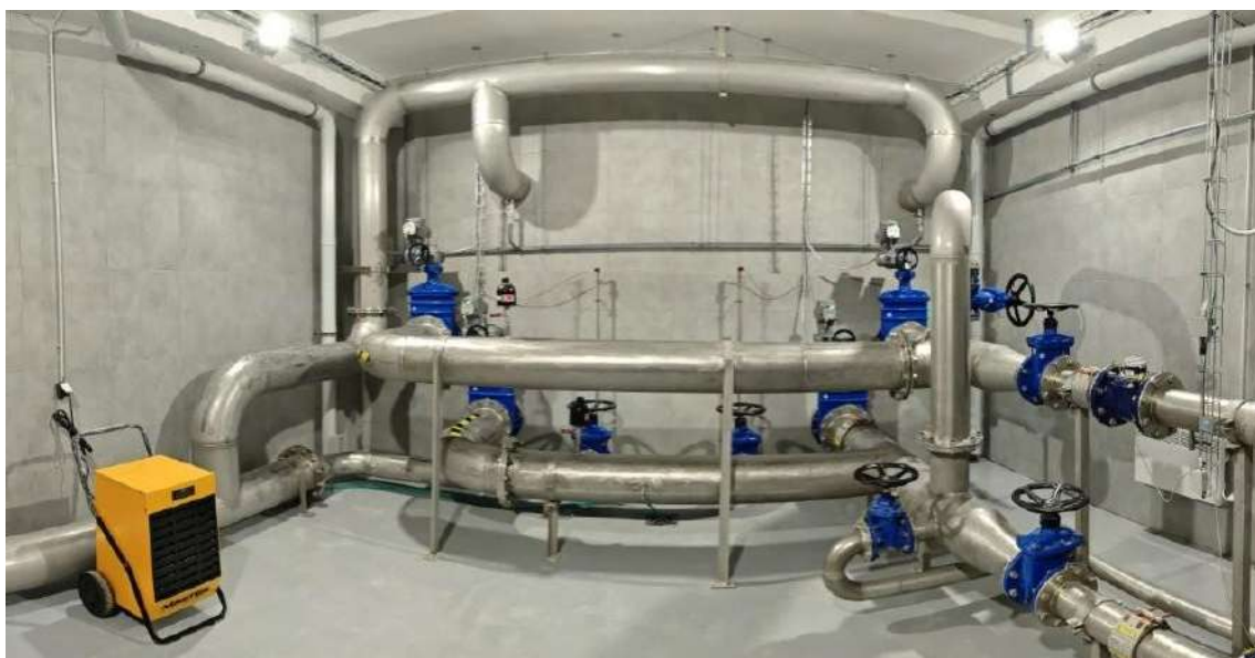
Obrázek č. 8 Optimální stav – vlhkost pod kontrolou
