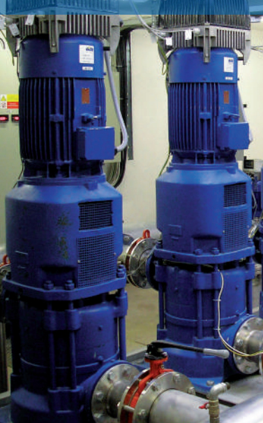
Čerpadla a čerpací stanice
