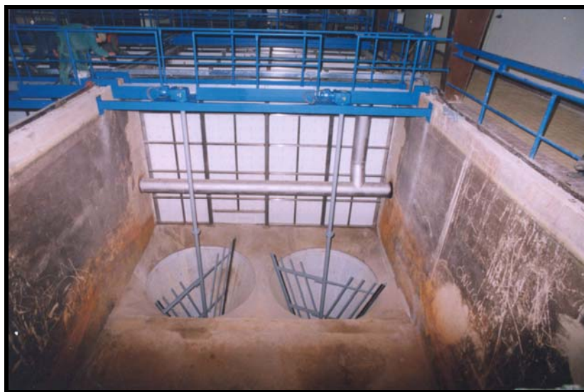
Nové kuželové kalové jímky se stíráním kalu a se spodním odtahem kalu
