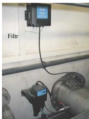
Obr. 6 : Fotografie instalované sestavy zákaloměrů.
