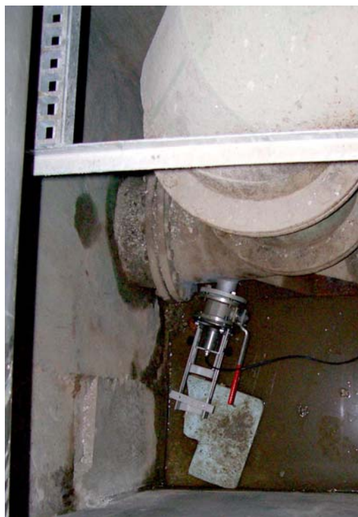
Zákal prací vody a stávajícím potrubí.
