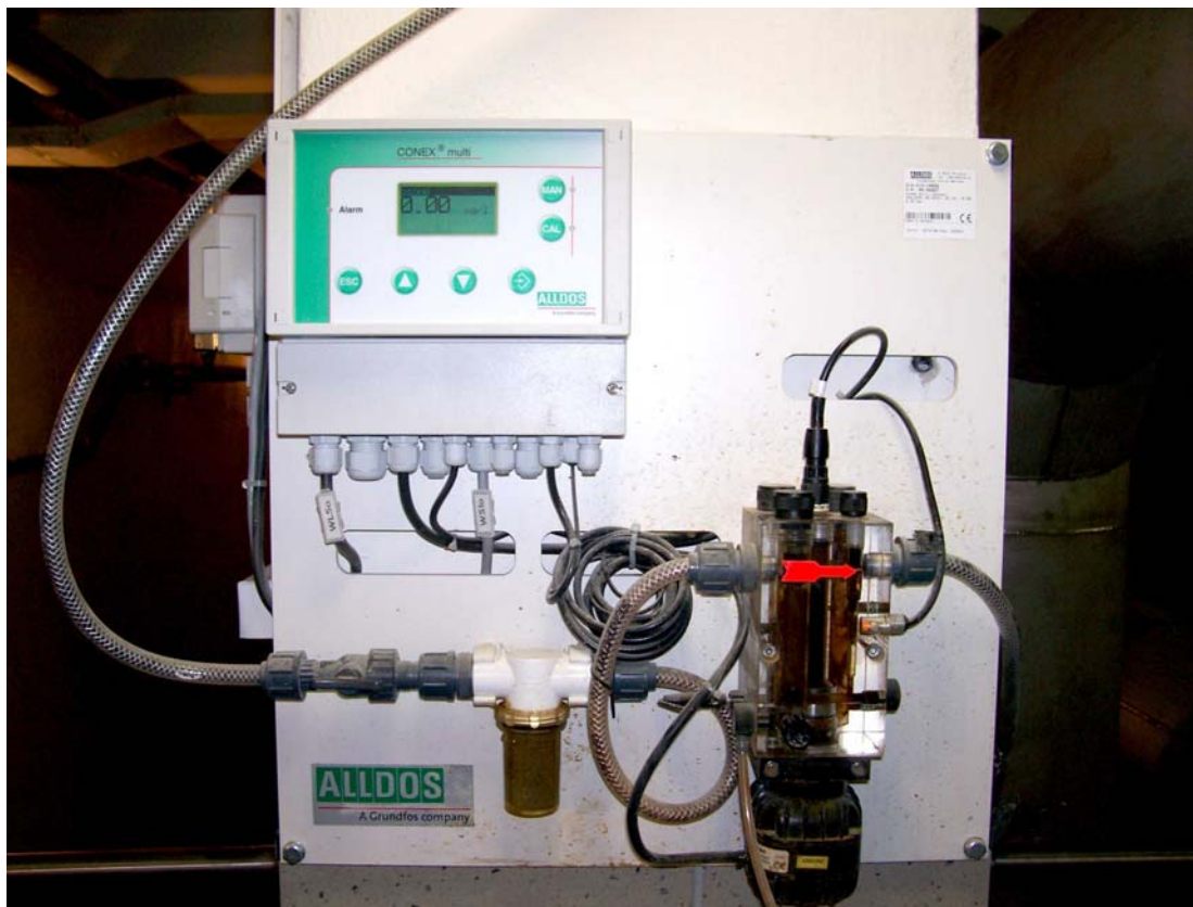
Analyzátor ozonu ve vodě, kde je instalován filtr vzorku a průtočný blok s čištěním.
