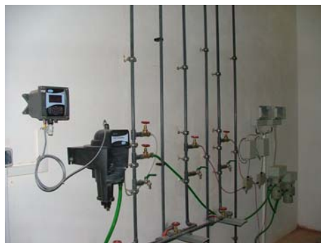
Obr. č. 4: Čerpací stanice Vsetín – Ohrada (analyzátory)
