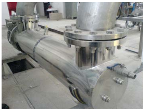
Obr. č. 5: Čerpací stanice Vsetín - Ohrada (nízkotlaká UV – Wedeco, směr VDJ Sychrov)
