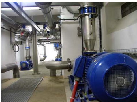
Obr. č. 3: Čerpací stanice Vsetín – Ohrada (horizontální čerpadla VOGEL)
