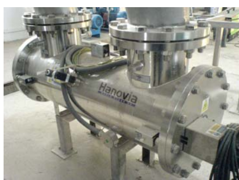
Obr. č. 6: Čerpací stanice Vsetín – Ohrada (středotlaká UV-Hanovia, směr VDJ Bečevná)
