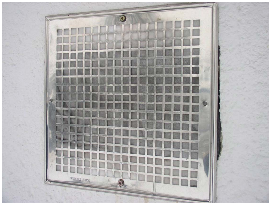
Obr. 2. Větrací otvor vodojemu s instalovanou rounovou textilií
