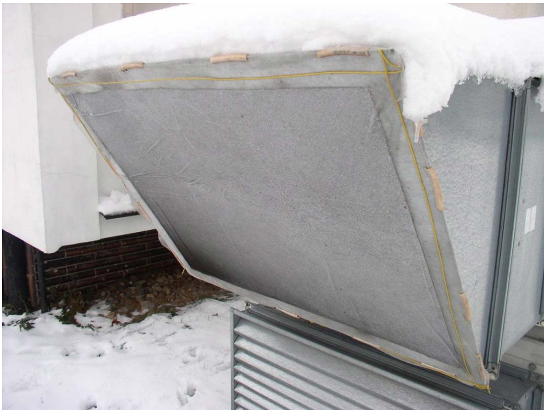
Obr. 1. Filtroventilační zařízení na úpravně vody
