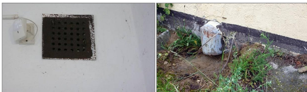
Obr. 6. Nevhodně umístěné vývody větrání akumulční nádrže.
