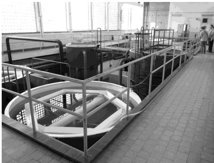
Obr. 1 ÚV Frýdlant – Celkový pohled do haly, v popředí filtry, za nimi čířiče
