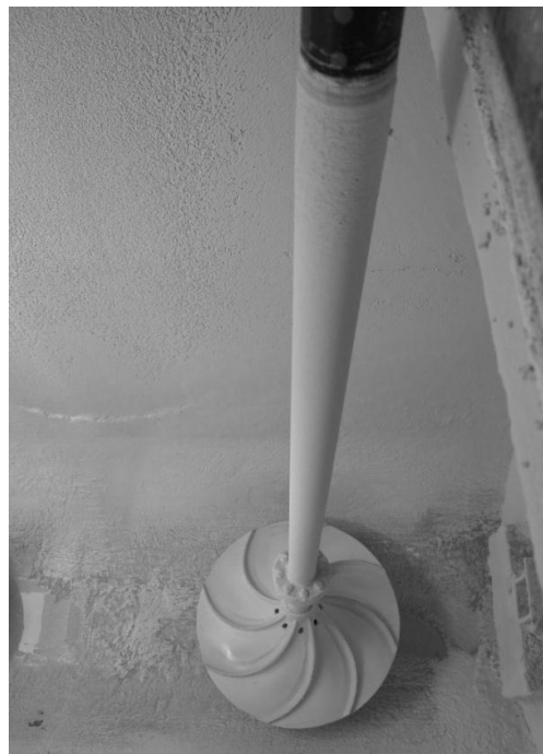
Obr. 6 ÚV Stakčín - hyperboloidní míchadlo nádrže vápenného mléka po 3 měsících provozu (před čištěním)
