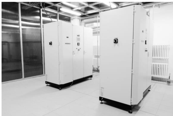
Obr. 1: Úpravna vody Kroměříž - generátory ozónu WEDECO SMO 200
