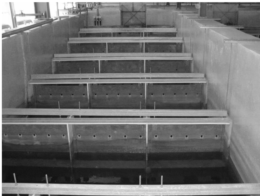
Obr. 1: Flokulační nádrže osazená děrovanými stěnami
