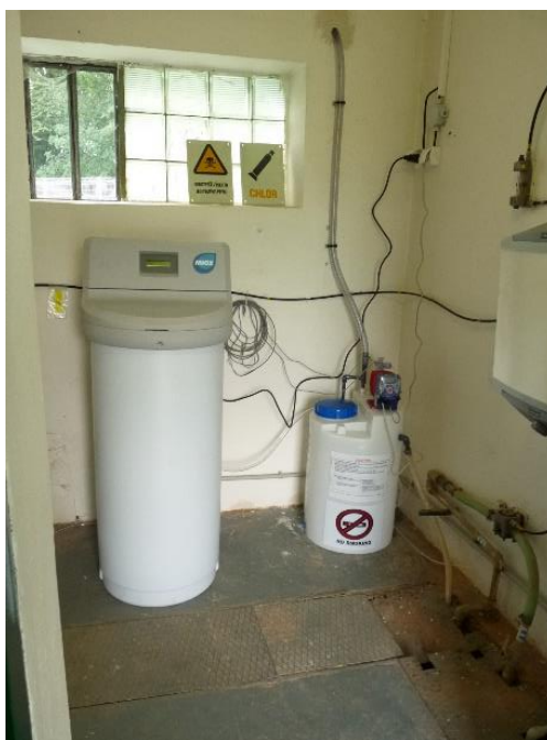
Obr. 1 Nainstalovaná jednotka pro výrobu směsných oxidantů Aquion MIOX ZUNI s kapacitou 0,45 nebo 0,9 kg ekvivalentu volného aktivního chloru za den
