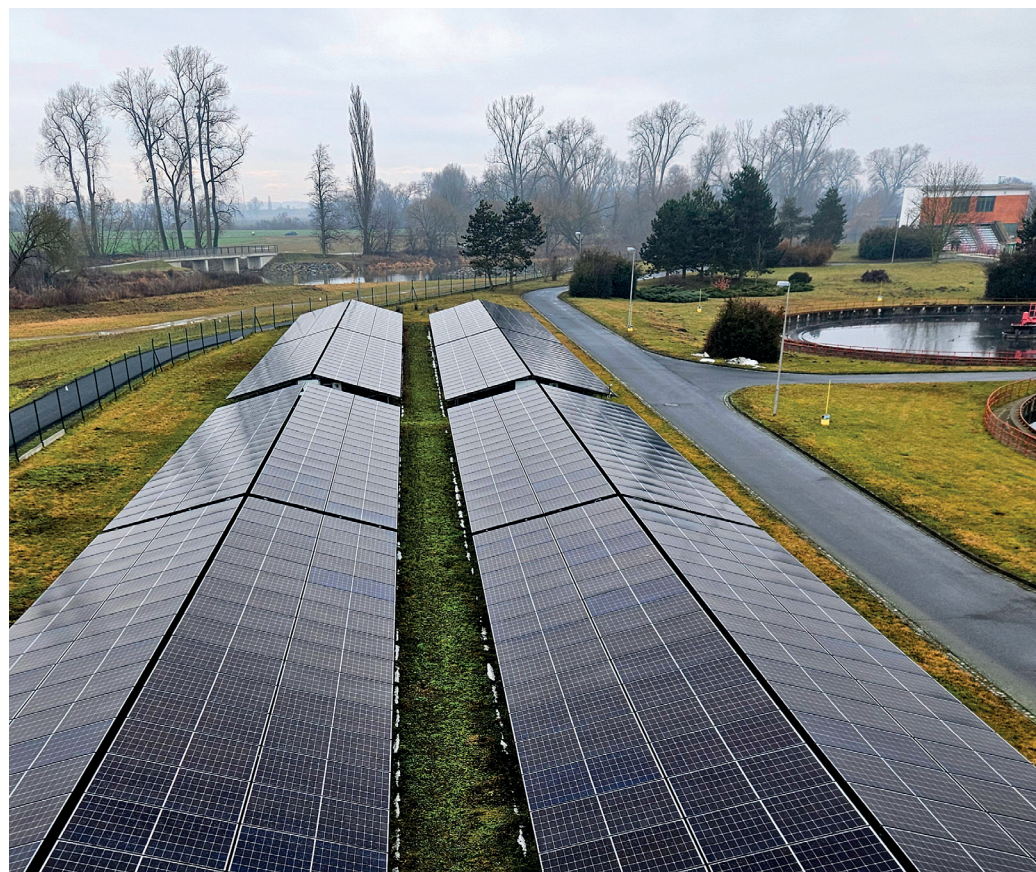
Novou fotovoltaickou elektrárnu tvoří 804 panelů s výkonem 403 kWp.
