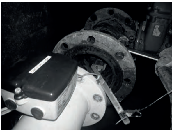
Obr. 2 Výměna kuponů na odtoku z VDJ Hodušín
