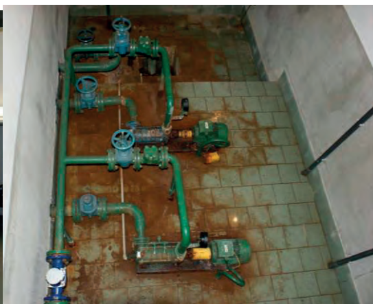
Obr. 2 Technologická část ČS č. 2
