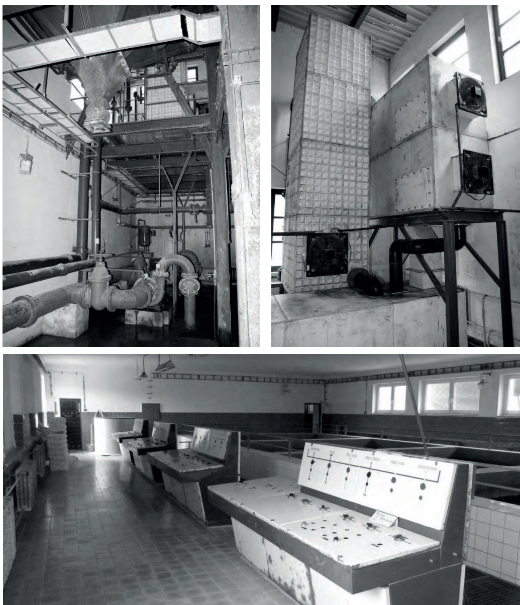
Obr. 2, 3, 4 Přítok surové vody, provzdušnění, písková filtrace
