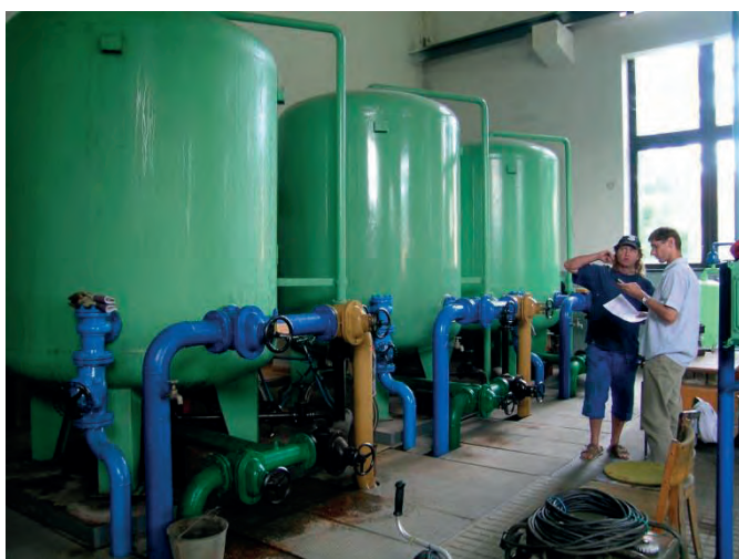
Obr. 1 Původní ÚV – tlakové filtry
