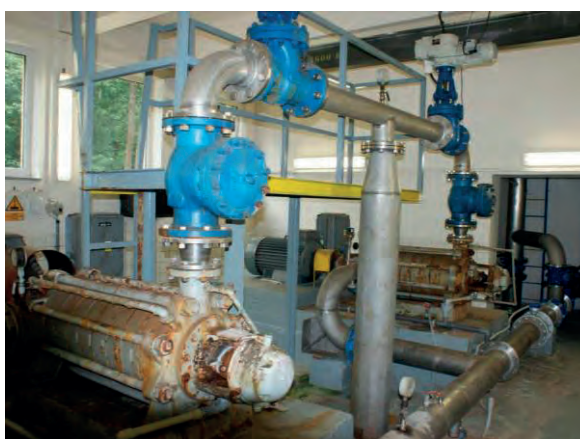
Obr. 1 Technologická část ČS č. 1
