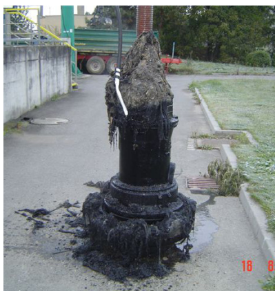
Tuky v kanalizaci
