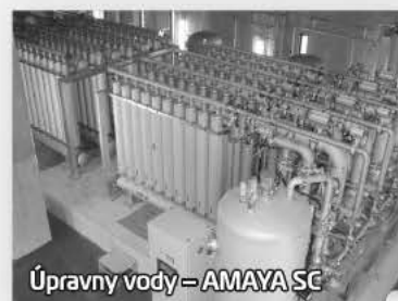
Úpravny vody – drenážní systém
