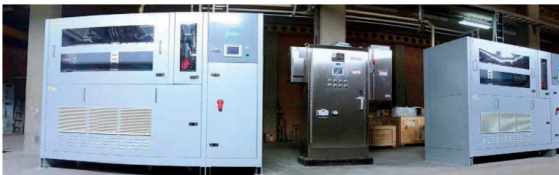
Obr. 5 Úpravna vody Francisco Wiesner, Bogotá, Columbie, rok instalace 2011 (řada Aquion MIOX Rio Grande, kapacita výroby jedné jednotky 450 kg/den ekvivalentu volného aktivního chloru)
