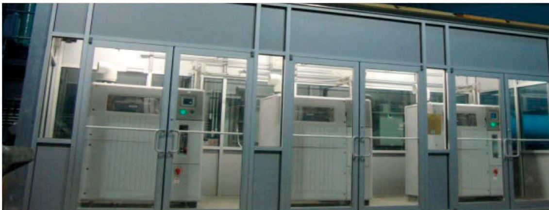
Obr. 6 Úpravná vody Keokuk, Iowa, USA, rok instalace 2013 (řada Aquion MIOX Rio, kapacita výroby 27,4 – 136 kg/den ekvivalentu volného aktivního chloru)
