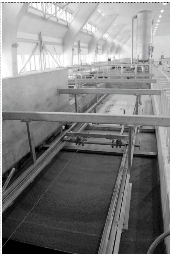
Obr. 5 Pohled na jednotku flotace
