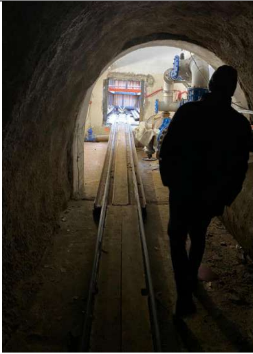
Obr. 4 Průhled přes dolní portál do startovací jámy a kolejová trasa pro zavážení potrubí do štol
