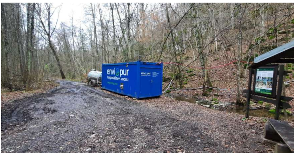
Obr. 1. Poloprovozní jednotka v kontejnerovém provedení v lesní lokalitě Říčky
