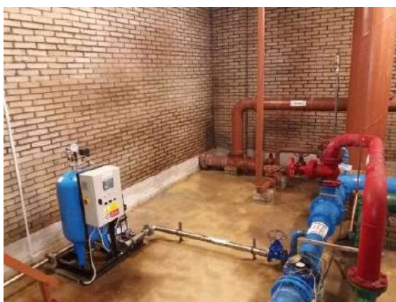
Obrázek č. 5 Stav před sanací
